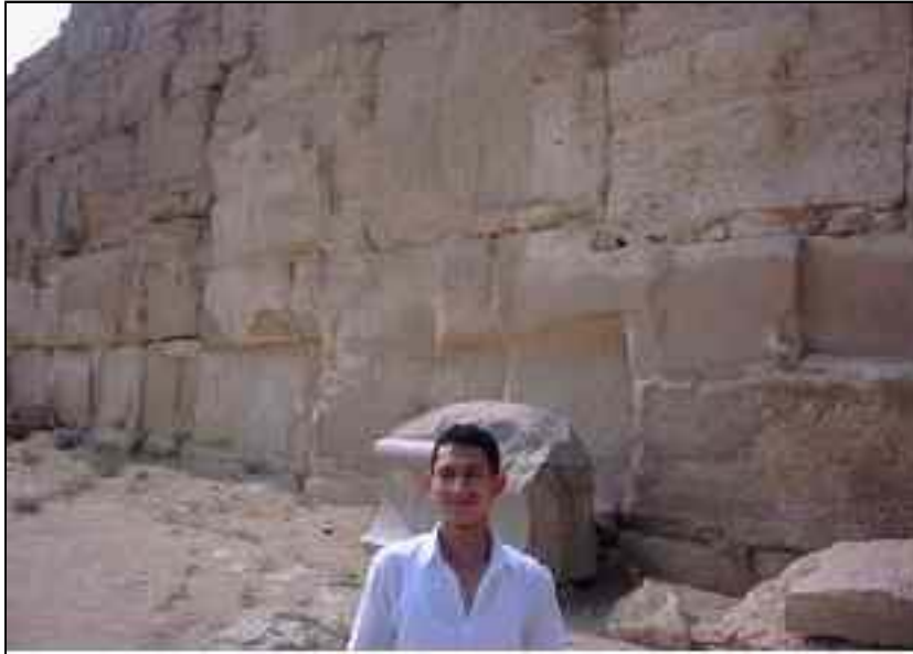
Die Sandstein-Außenverkleidung weist starke Erosionserscheinungen auf.
